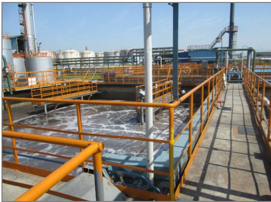
废水处理设施
