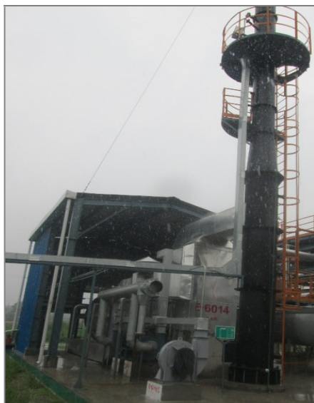
焚烧炉废气排口
